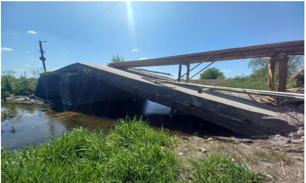
Рисунок 2.1 – Руйнування прогонових споруд та опор внаслідок підриву
