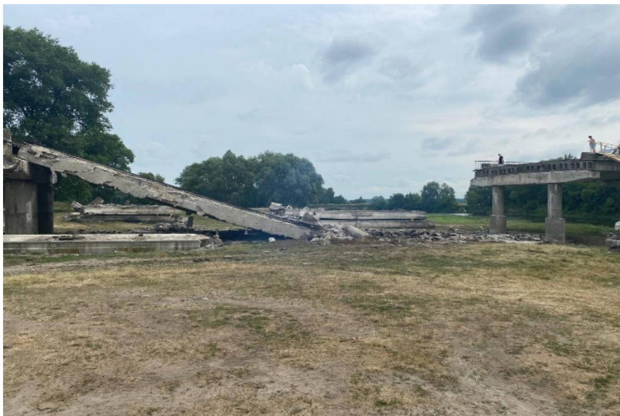
Рисунок 3.8 – Обрушення прогонових споруд мосту через р. Сейм
