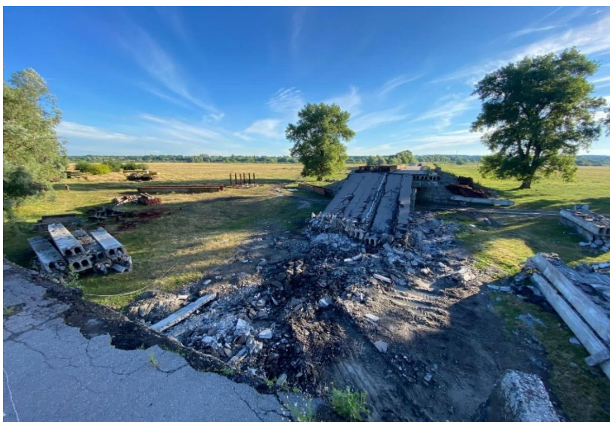
Рисунок 3.9 – Характер руйнування опори мосту через р. Сейм
