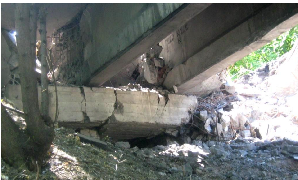
Рисунок 2.3 – Руйнування пальового фундаменту на високому ростверку внаслідок підриву боеприпасом великої потужності
