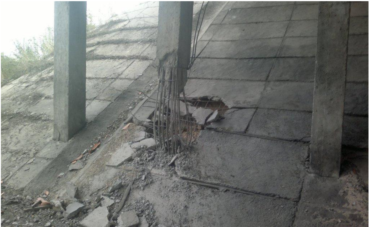
Рисунок 2.4 – Руйнування пальового фундаменту опори естакадного типу
