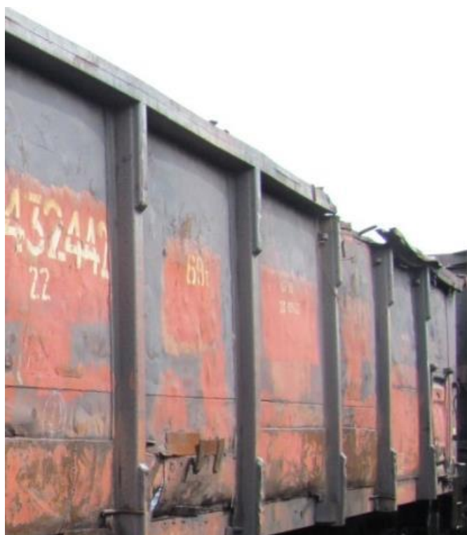
Рисунок 2.6 – Пошкодження верхньої обв'язки бокової стінки піввагона
